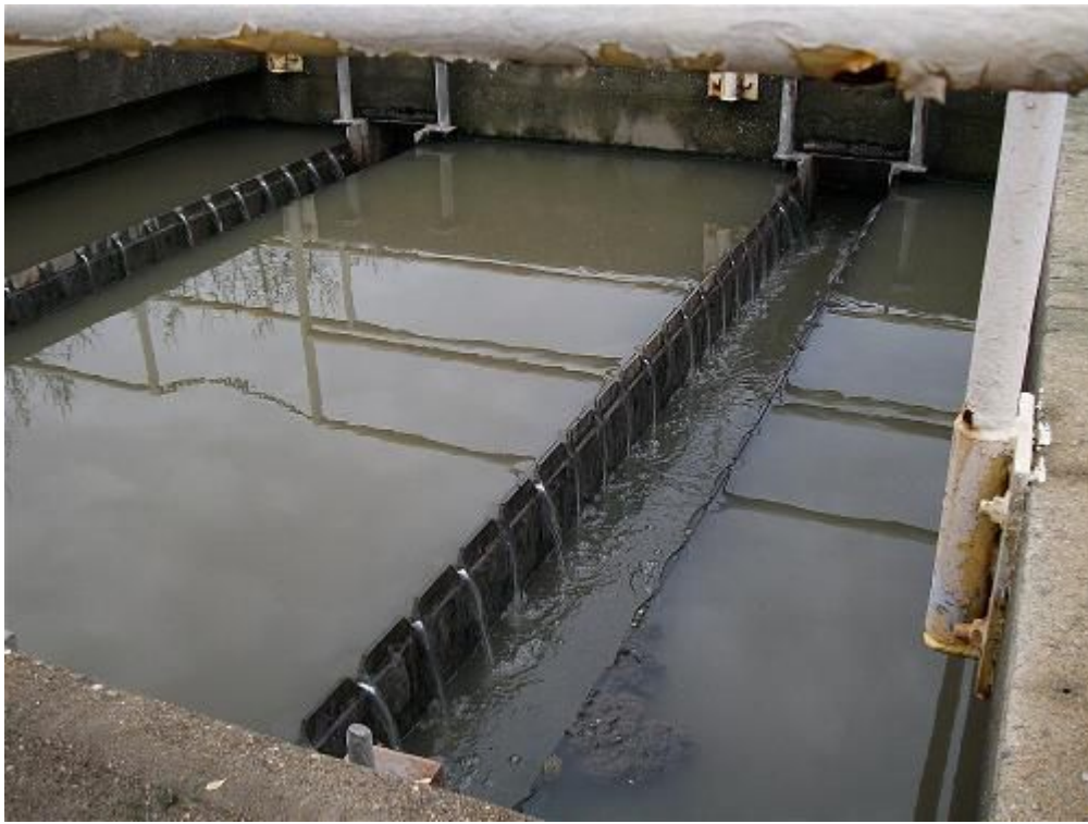
Điểm đến của nước cống tại nhà máy lọc.
